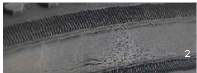
Afbeelding 50: Voorbeelden van vermoeiingsscheuren (1) en verouderingsscheuren (2)
